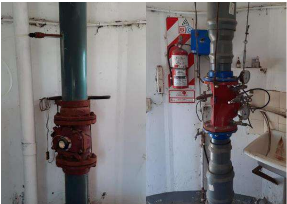
Imágenes 2 y 3. Válvula reductora de presión y macromedidor existentes al pie del tanque elevado.
