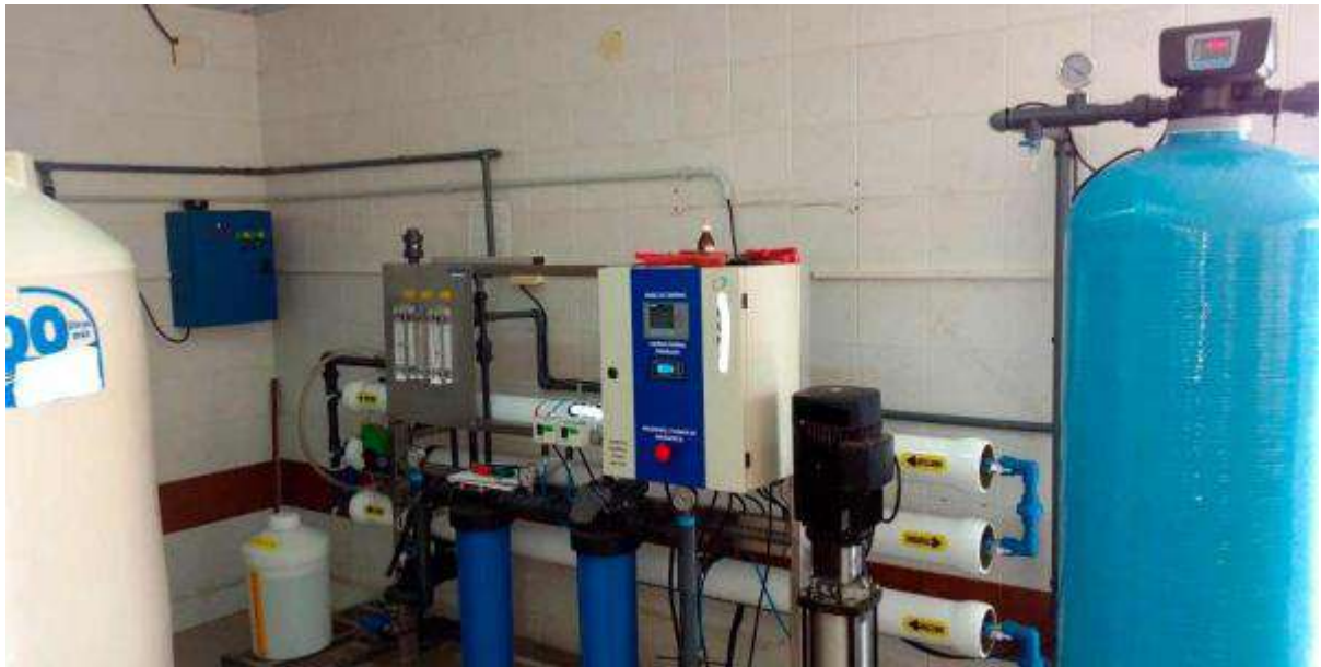
Imagen 1. Sistema de provisión de agua tratada mediante Osmosis Inversa existente con bidones.
