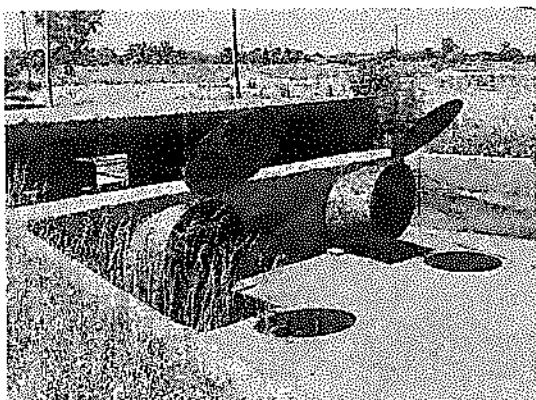
Figura 3. Equipo de bombeo – Estación de Bombeo 1
