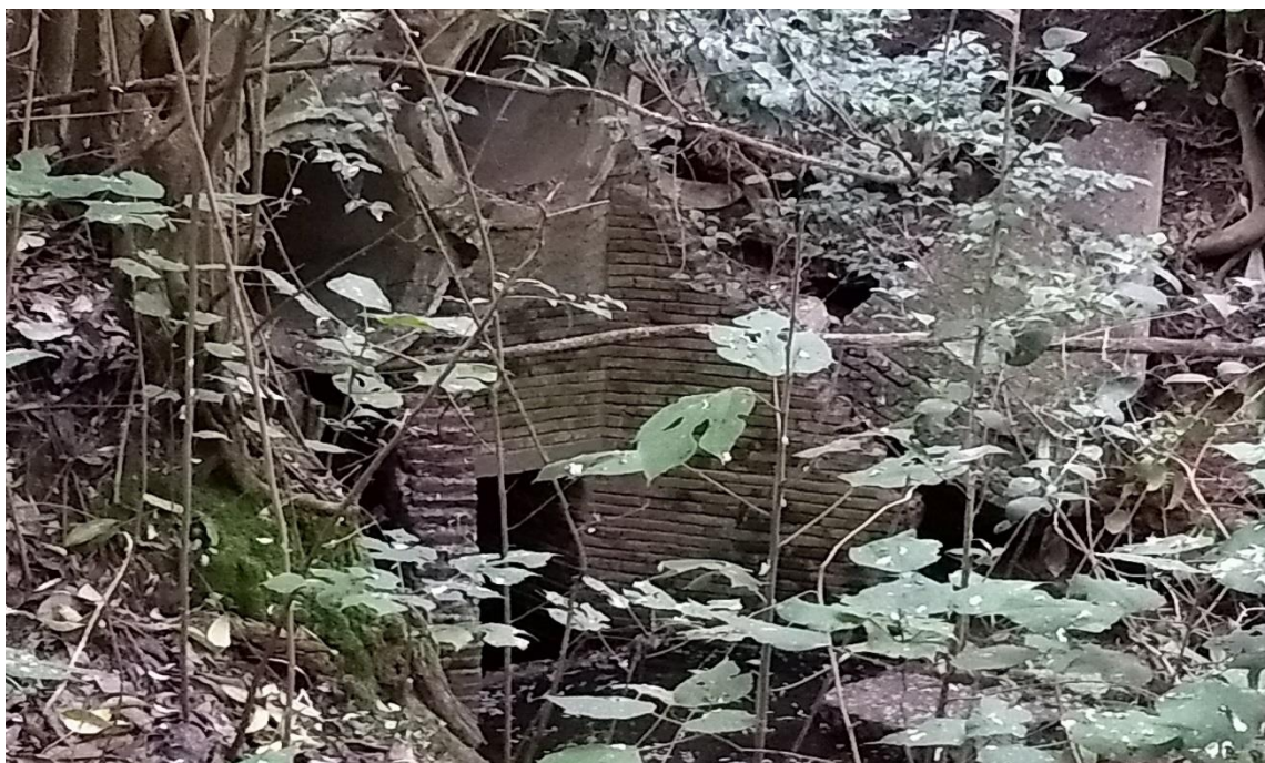
Canal en el Batallón. Alcantarilla 4 destruida a retirar Vista desde aguas arriba. 50 m antes del río Paraná, sobre una antigua traza FC
