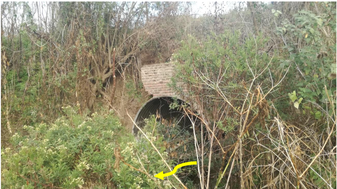
Vista alcantarilla transversal del FC Belgrano, desde aguas abajo. Muro de cabecera de ladrillos, destruido
