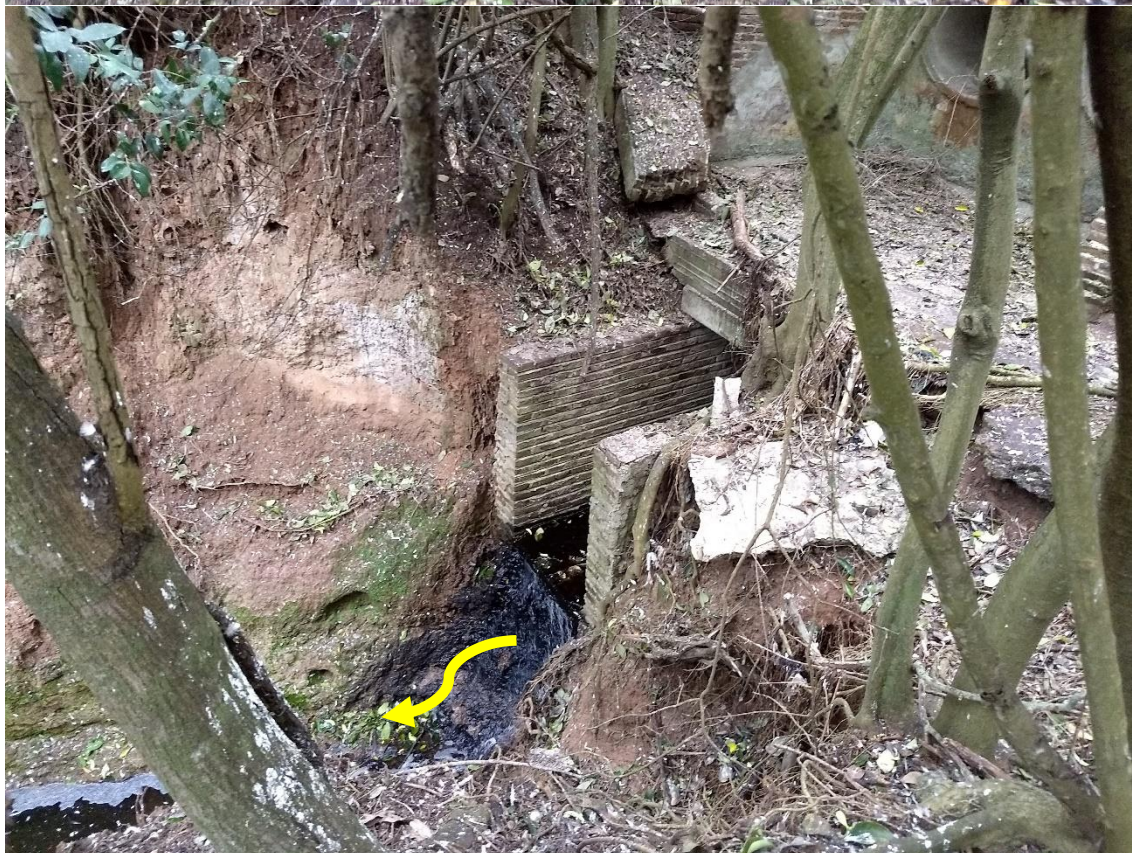
Canal en el Batallón. Alcantarilla 4 destruida a retirar Vista desde aguas abajo. 50 m antes del río Paraná, sobre una antigua traza FC
