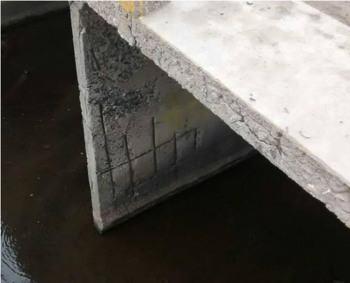
Imagen 28: Armadura Puente sin el recubrimiento de hormigón sobre calle Gabasio
