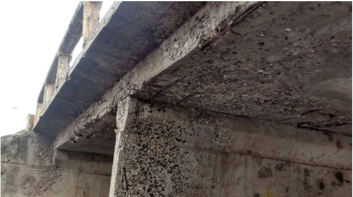
Imagen 29: Armadura Puente sin el recubrimiento de hormigón sobre calle Gabasio
