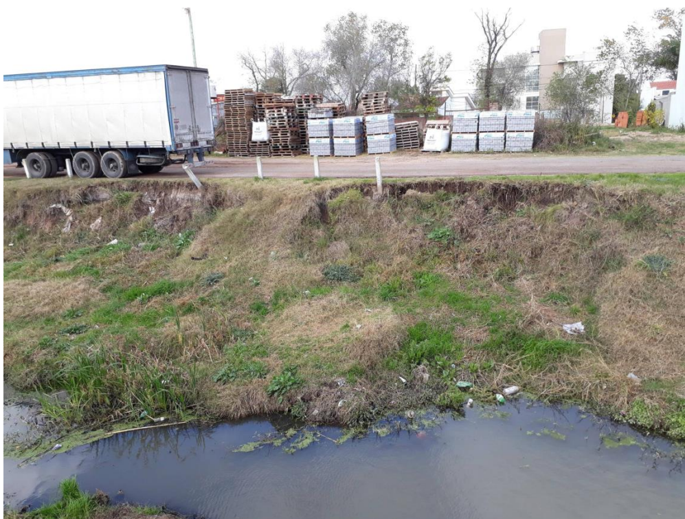
Imagen 22: Erosión en talud Sur 30m lineales.
