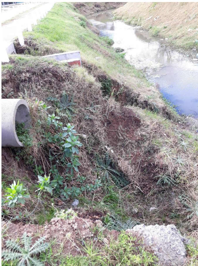
Imagen 23: Desagüe calle Leloir 4m lineales margen Norte.
