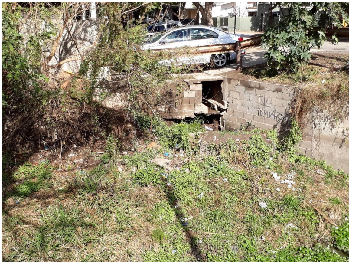
Imagen 20: Desagüe calle Falucho Margen Sur 4m lineales
