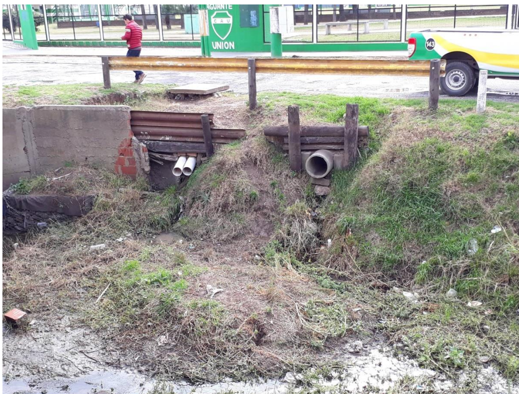
Imagen 14: Desagües Italia margen Norte 10m lineales margen Norte.
