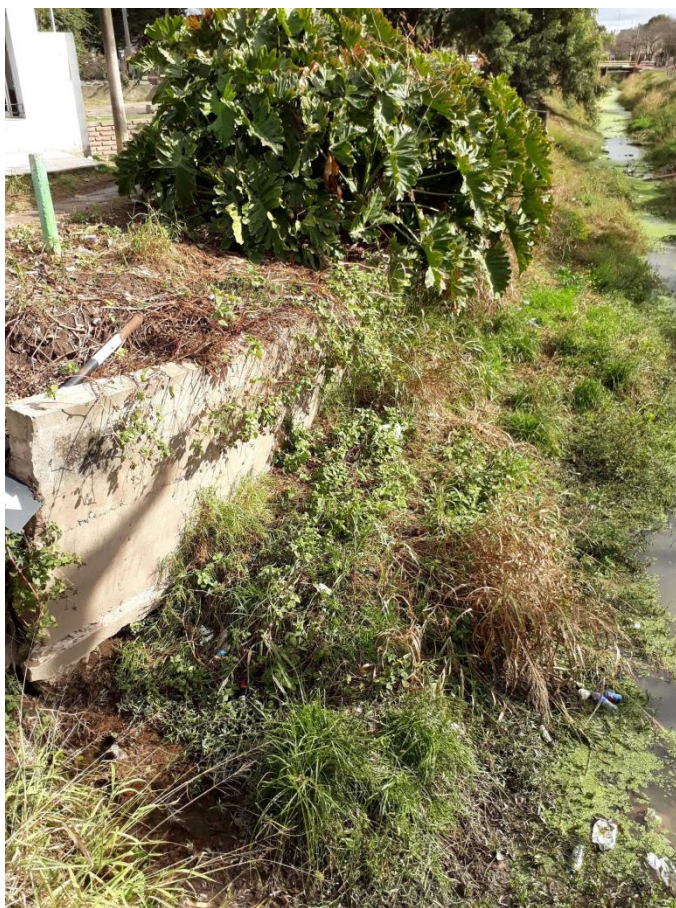
Imagen 13: Protección existente colapsada sobre Av. Belgrano 10m lineales margen Sur.
