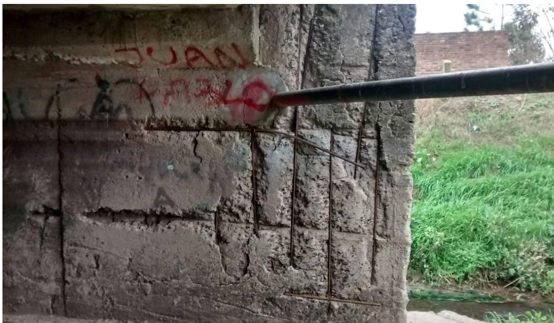
Imagen 35: Armadura sin recubrimiento en Puente sobre calle Ameghino.
