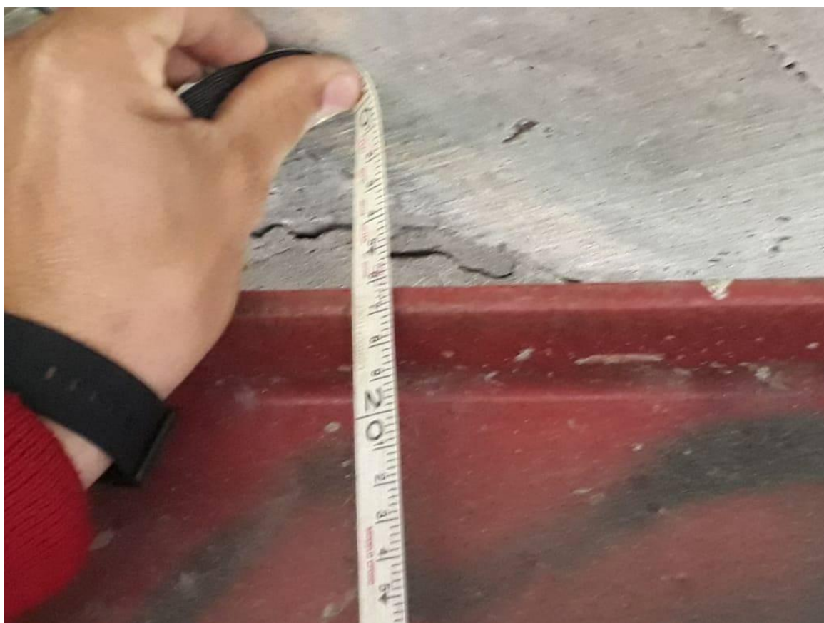
Imagen 38: Flecha permanente del tablero 6cm
