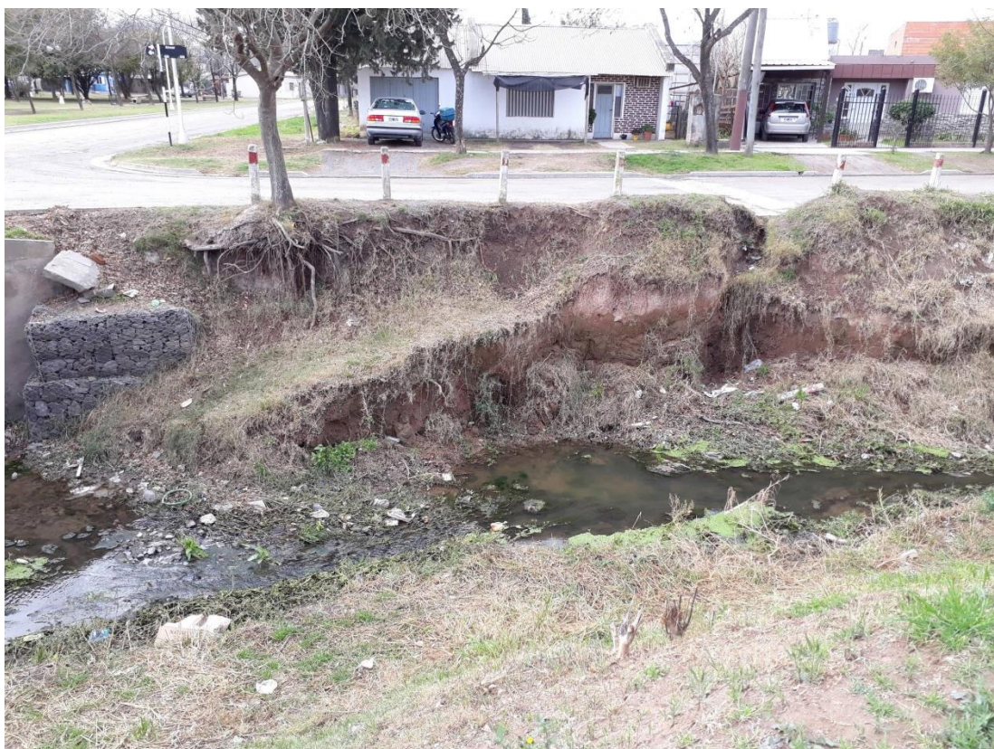
Imagen 16: Desagüe calle Alvear 15m lineales margen Este.
