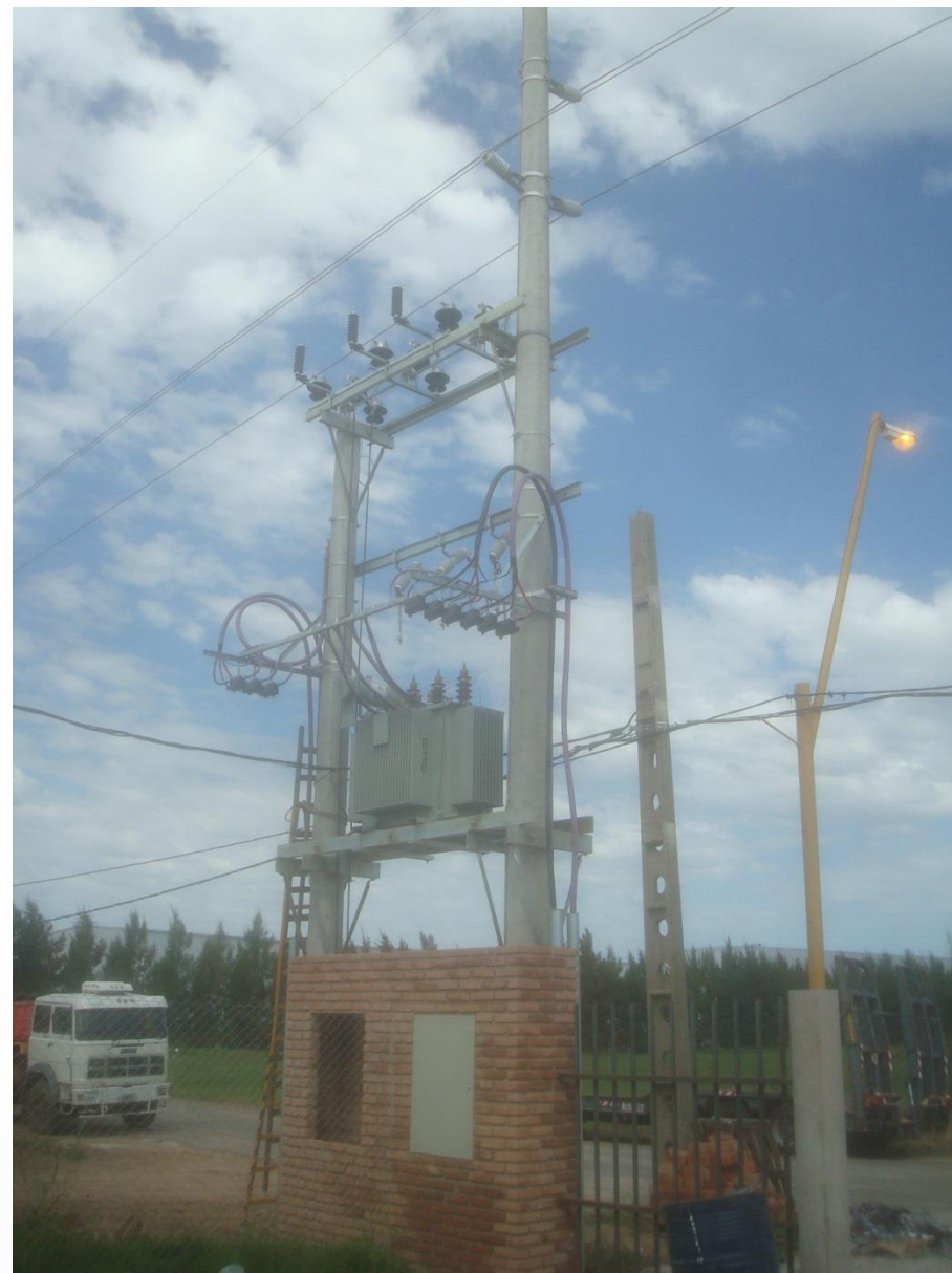
Acometida en Baja Tensión - 380 V
