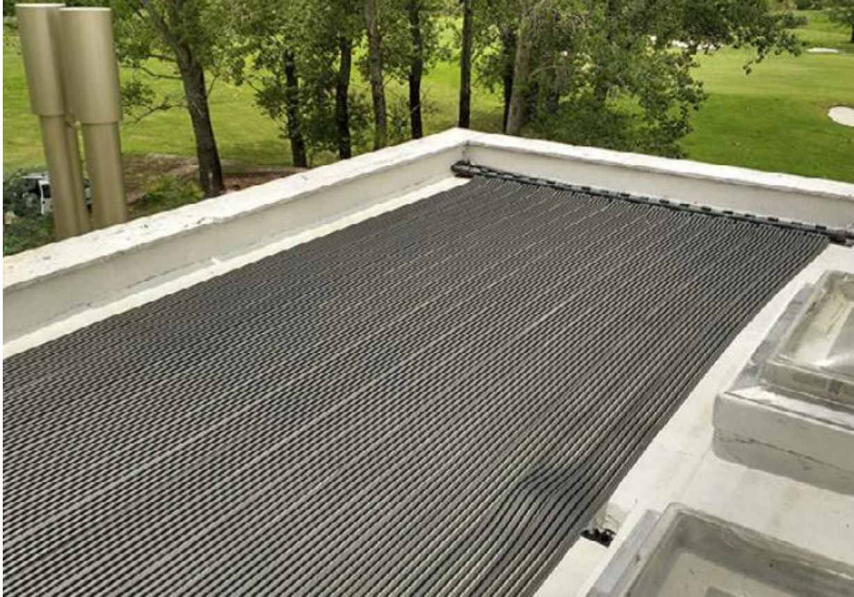
Figura 13: Colectores EPDM instalados sobre el techo de una vivienda
