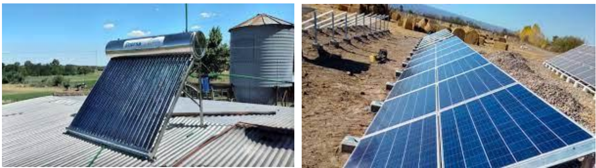
Figura 7: Ejemplo de instalaciones solares (sistema solar térmico compacto - termotanque solar- a la izquierda y paneles fotovoltaicos a la derecha)
