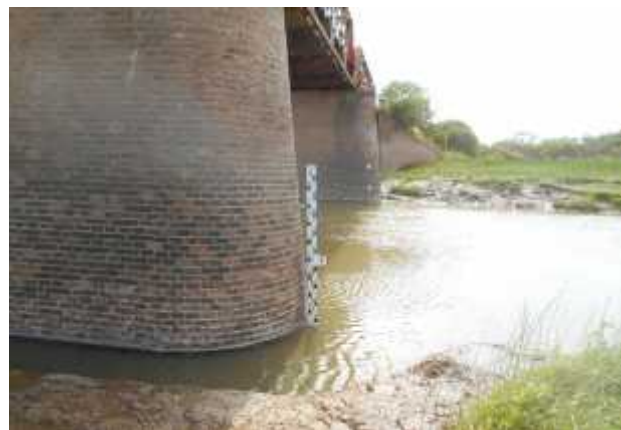
Escala Hidrométrica Tramo 0 a 2 m
