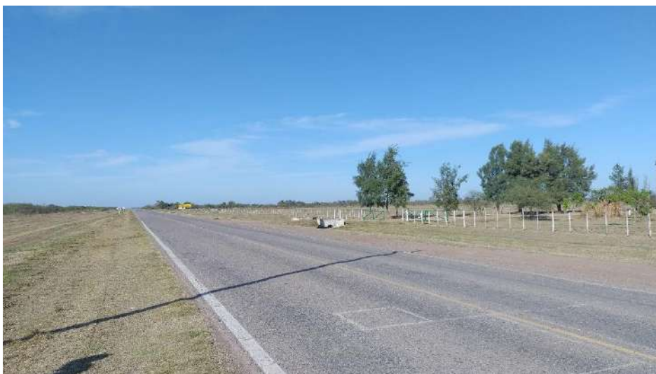
Figura 6. Deformación y exudado de la calzada
