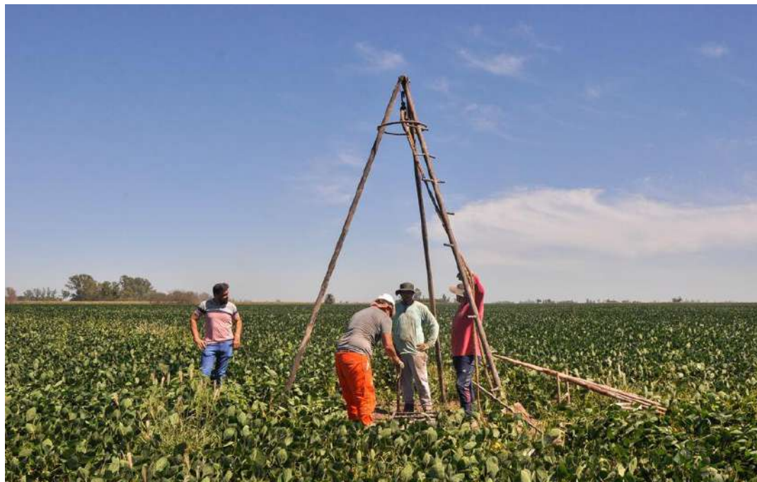
Imagen 13. Ejecución de perforaciones para estudio de suelo y detección de la posición de la capa freática
