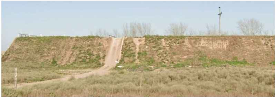
CARCAVAS 4 Y 5 DESLIZAMIENTO 3
