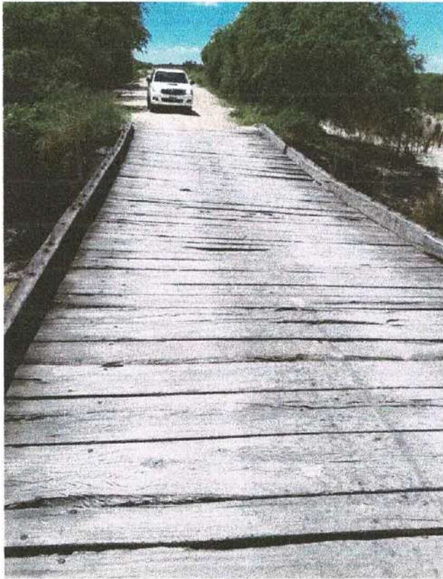
Figura 4. Estado actual estructuras sobre Arroyo El Rey
