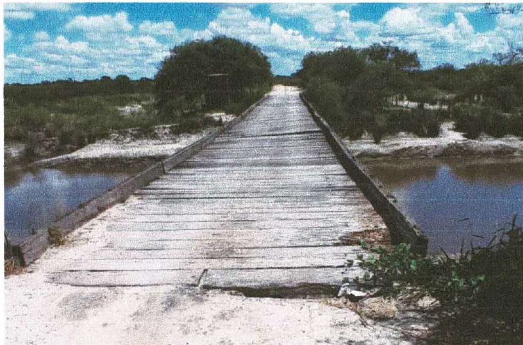
Figura 3. Estado actual estructuras sobre Arroyo El Rey
