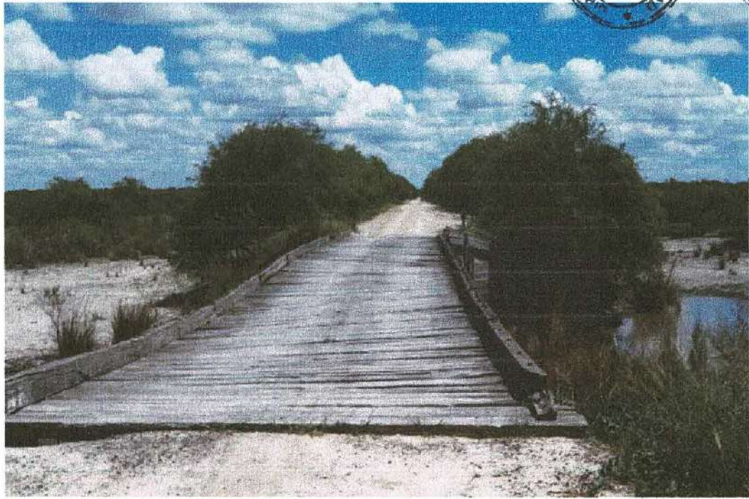
Figura 2. Estado actual estructuras sobre Arroyo El Rey
